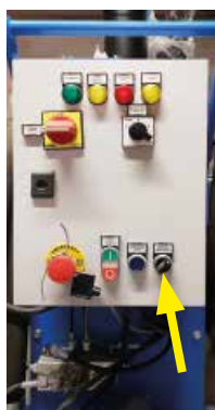
Démarrage/arrêt du groupe motopompe pour compteur de particules
