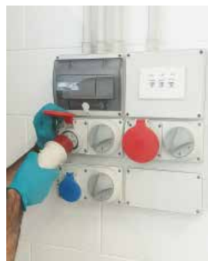
Branchement sur prise triphasée
