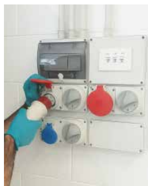
Raccordement électrique pour moteur triphasé (fiches 5 broches) Fig.6
