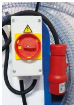
Coffret électrique triphasé
