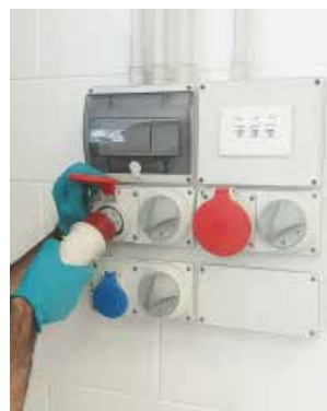
Branchement sur prise triphasée
