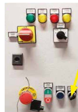
Avec indicateur électrique Fig.21 et compteur de particules
