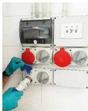
Branchement sur prise monophasée
